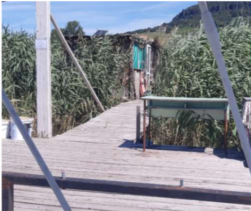
Illegális bejáró és tűzveszélyes felépítmény bontása
